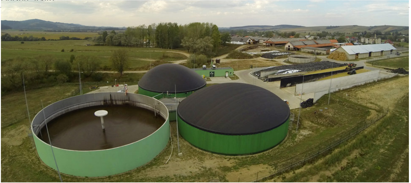
Fot 1. Biogazownia w Odrzechowej (zdjęcie z serwisu http://odrzechowa.com.pl/projekt/biogazownia/biogaz.html )
