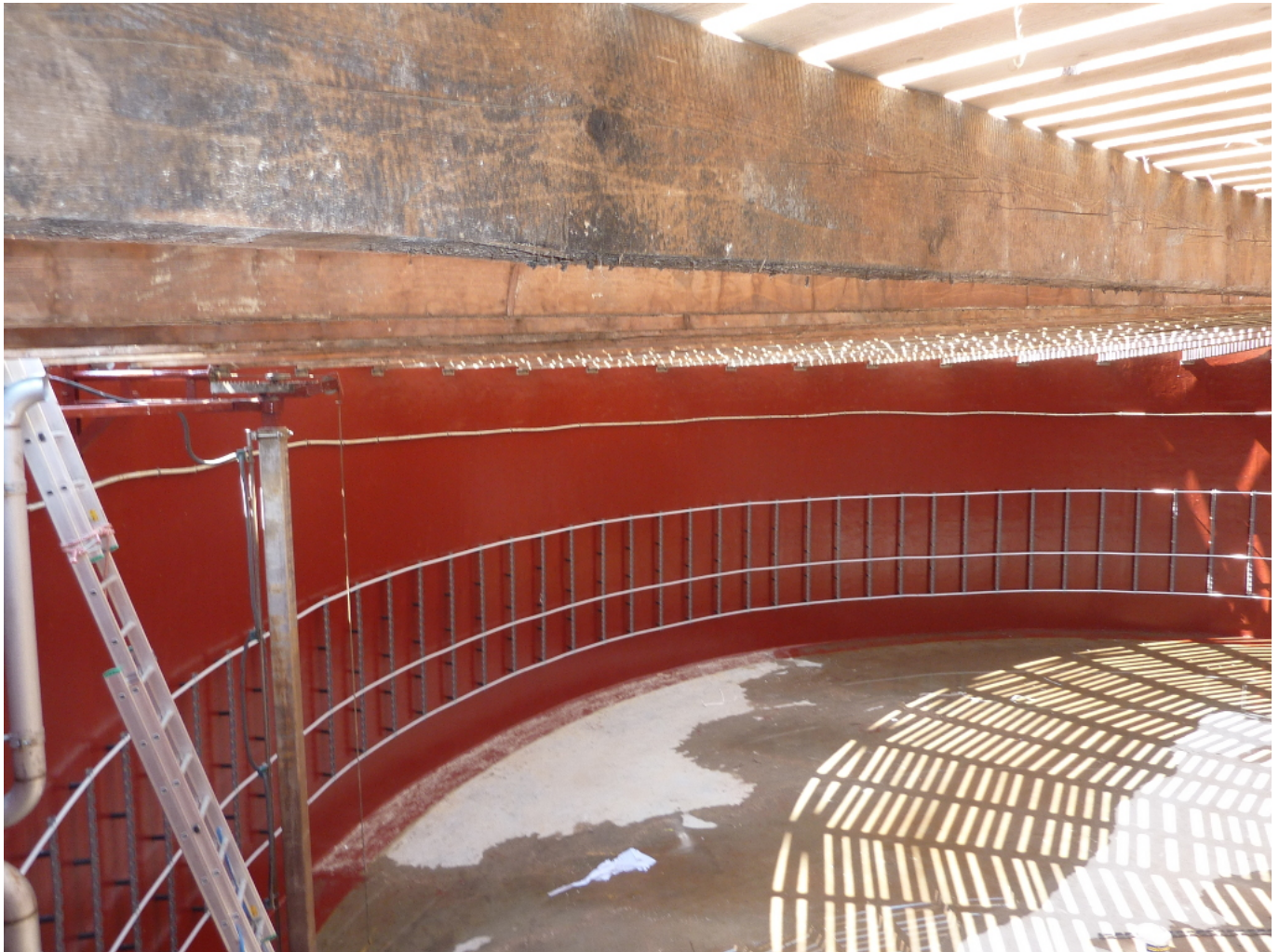
Fot 4. Widok zbiornika od wewnątrz (bioreaktora)
